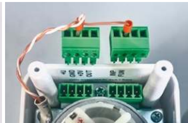
Фото 23. Подключение проводного выключателя
